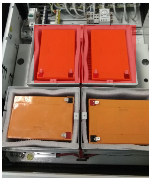
Рисунок 9.3 – АКБ, установленные в термостаты
